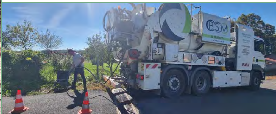
Débouchage canalisation obstruée par bouchon de calcaire
